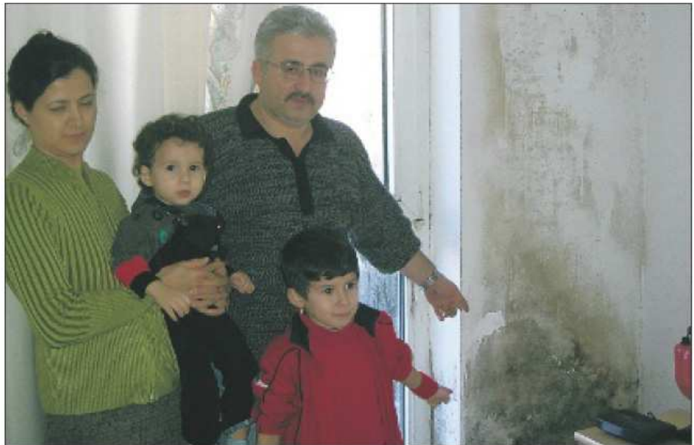
Die Wohnung der Familie Pekel im Schimmel-Viertel wurde im Januar sogar vom Gesundheitsamt gesperrt. Andere Mieter leben bis heute mit Pilzbefall an ihren Wänden.
